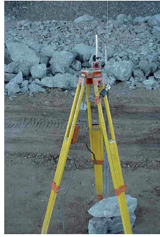
capteur de déplacement LVDT sur trépied (Cerema)
