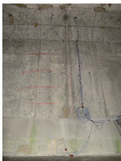
Photo 1 : Câblage d'une verticale de capteurs implantés dans l'âme d'une poutre précontrainte (Cerema)
