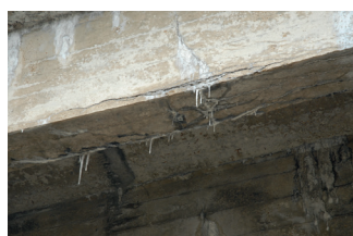
Fissures le long des aciers (lfsttar)
