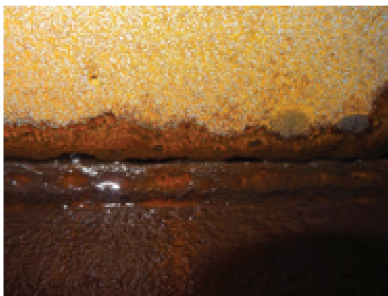
Fissure unique (ligne)
