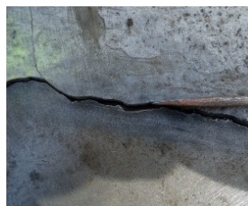
Absence de continuité métallurgique : fissure directement observable
