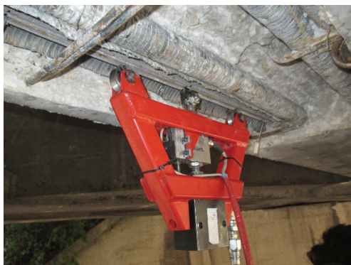
Arbalète en position de mesure sur un fil en sous-face de poutre de VIPP (Cerema)
