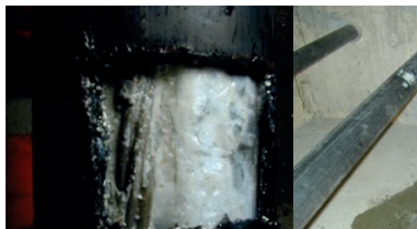
Fenêtre ouverte au moyen d'un outil électroportatif dans un conduit en PEHD, présence d'un toron, de pâte blanche et d'humidité (photos Cerema)
