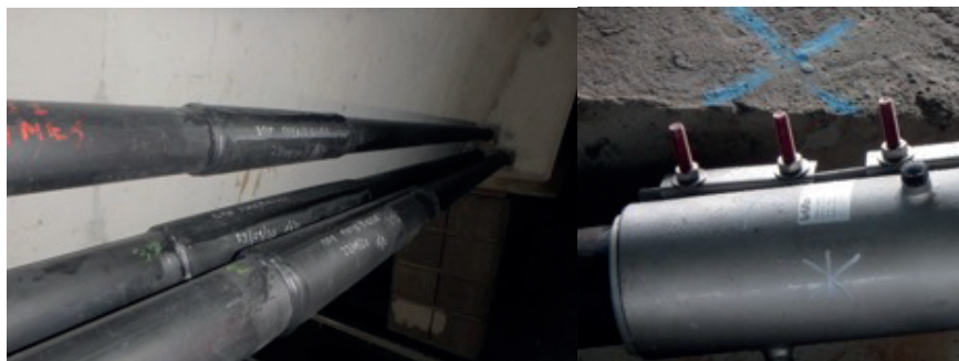
Fermetures définitives par soudure sur PEHD (recommandée) // par collier rapporté en inox (photos DGITM/DMR/FCA)
