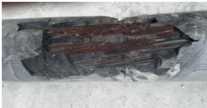
Coulis désorganisé et corrosion de fils (photos Cerema)
