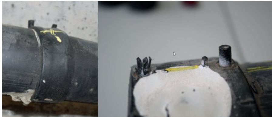
Manchon déformé et coulure de coulis (photo Cerema) // Témoin de soudure absent (photo DGITM/DMR/FCA)
